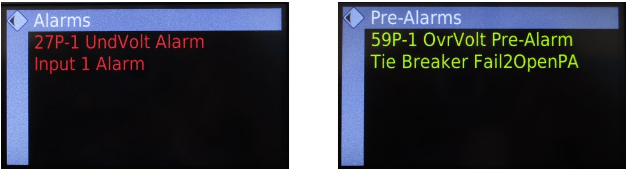
Figura 3-38. Pantallas de alarmas del panel frontal y prealarmas
